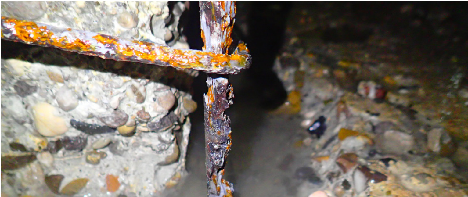
3 Bewehrungskorrosion an einem Stützenfuß infolge Chlorideinwirkung (Quelle: Hochschule München)
