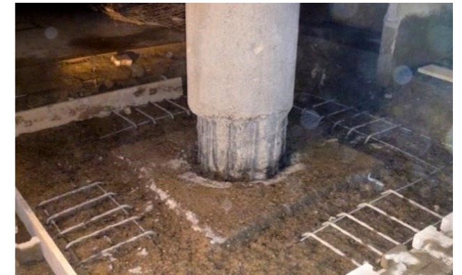
4 Notwendige Instandsetzungsmaßnahme bei Fundament unter Pflasterbelag (Quelle: IB Schieß Gehlen Sodeikat GmbH)
