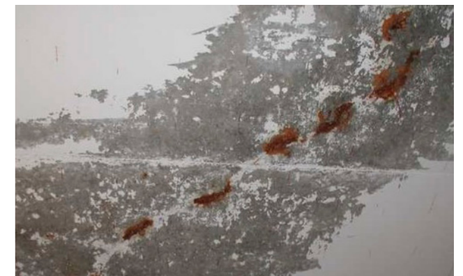
5 Korrosion der unteren Bewehrungslage eines Zwischendecks infolge eines Trennrisses (Quelle: IB Schieß Gehlen Sodeikat GmbH)
