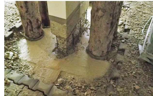
1 Bewehrungskorrosion an einem Stützenfuß infolge Chlorideinwirkung (Quelle: Hochschule München)
