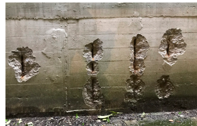
3 Korrosionsbedingte Betonabplatzungen im Wandfußbereich (Quelle: Steeltec AG)
