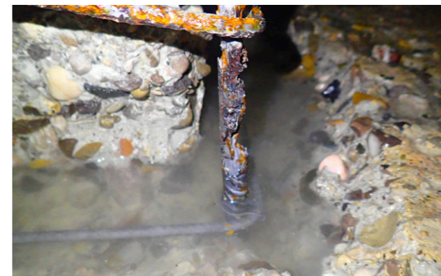
2 Detailaufnahme von Querschnittsverlust an Bewehrung (Quelle: Hochschule München)
